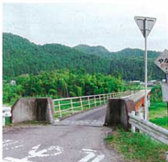
狭すぎる橋 那賀町築ノ上
